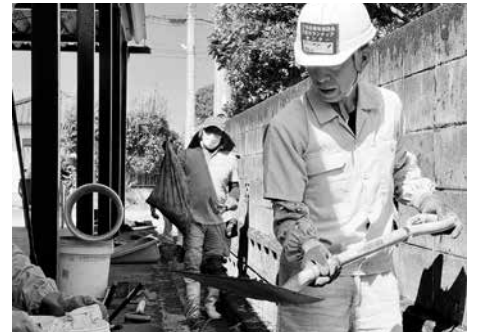
庭に流れ込んだ泥の泥出し
